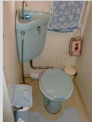
<写真の説明> 角付のロータンクに普通便座でした
