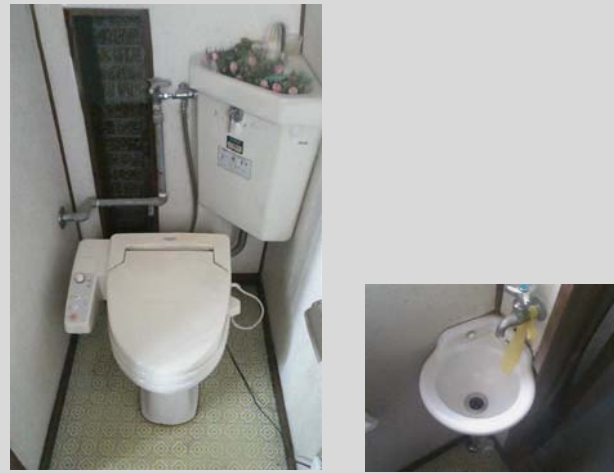
<写真の説明> 角付ロータンク、ウォシュレットはそで付きタイプでした 手洗器は小さく不便
